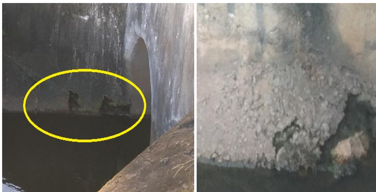
FIGURA 04: Desgaste por erosão e cavitação em pontos junto aos bueiros.
