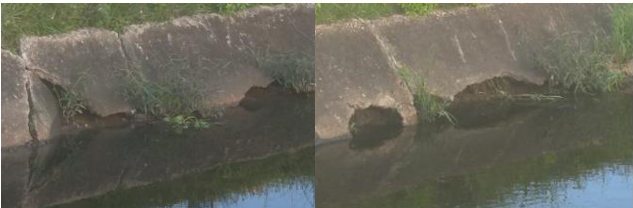
FIGURA 6: Desgaste por erosão e cavitação nas paredes laterais do canal.
