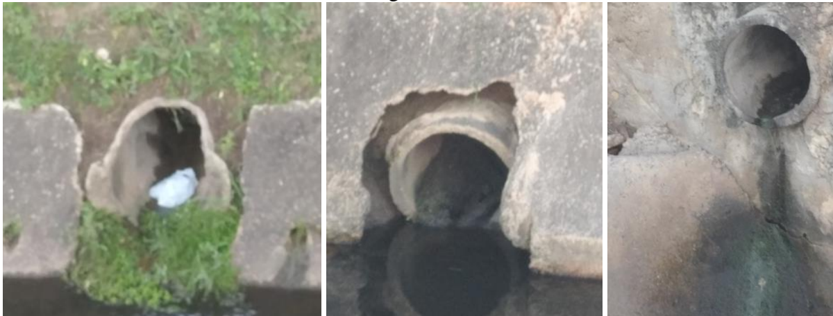
FIGURA 05: Desgaste por erosão e cavitação na ligação das galerias de águas pluviais com o canal de drenagem urbana.
