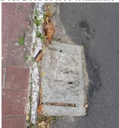
FIGURA 08: Boca de lobo totalmente obstruída.
