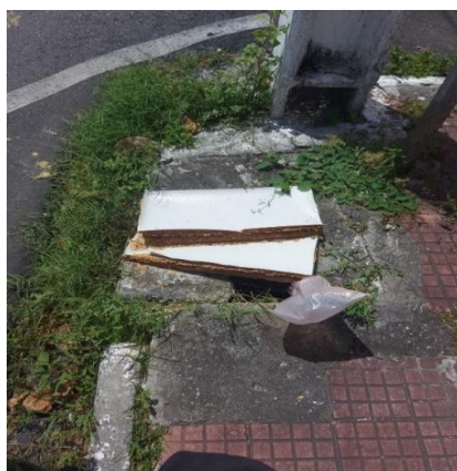
FIGURA 06: Exemplo de boca de lobo mal localizada e em péssimo estado de conservação.
